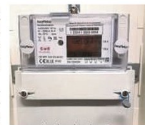
Stromzähler FOTOS PRIVAT
