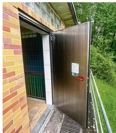
Hat bereits eine neue Sicherheitstür: der Hochbehälter im Ortsteil Motzenrode. FOTO: GEMEINDE MEINHARD
