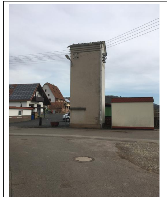
Das Transformatorenhäuschen in Schwebda
